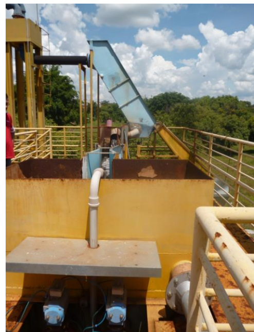
Foto 4.18 - Calha Parshall e Peneira
