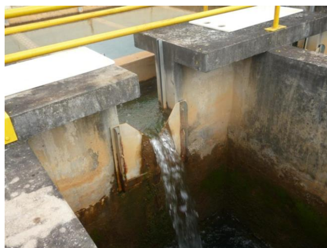
Foto 4.8 - Entrada dos Filtros
