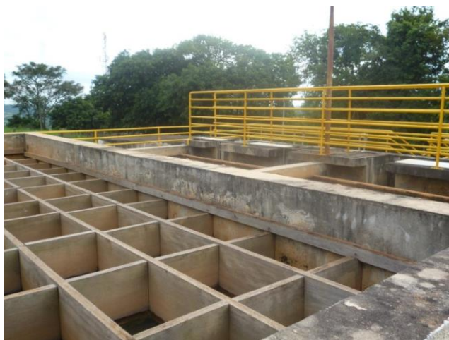
Foto 4.5 - Vista Geral da ETA
